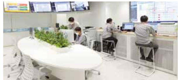
次世代の建物管理を実現する「集中管理センター」
