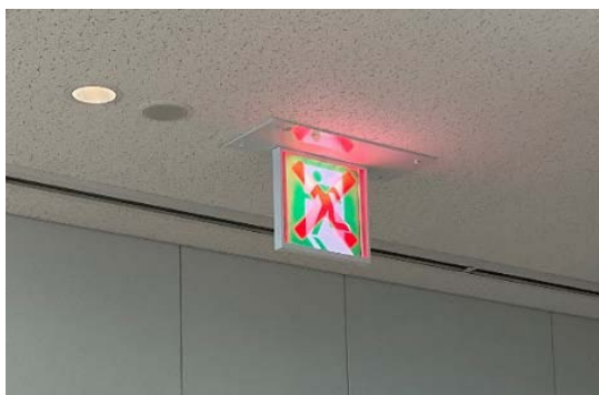
進入禁止を表示できる避難口誘導灯の設置状況
