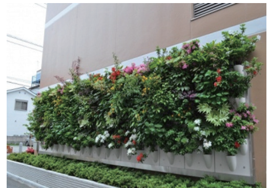
Photo 1 独身寮外壁適用事例（埼玉県蕨市） Outer wall application of the dormitory (Saitama Prefecture Warabi)
